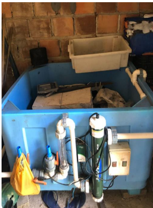
Figura 22: Depuradora sem funcionamento na localidade de Santiago do Iguape.
