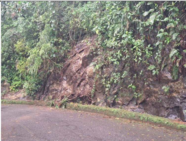
Figura 17: Paredão com eminente risco de queda de árvore e de blocos (Fotografia de 16/11/2022).
