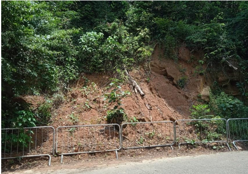
Figura 12: Movimento de massa gravitacional que está obstruindo a passagem dos pedestres (fotografia de 09/11/2022)
