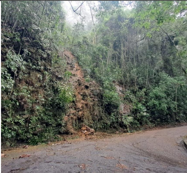
Figura 16: Paredão com eminente risco de queda de árvore e de blocos (fotografia de 20/07/2023).
