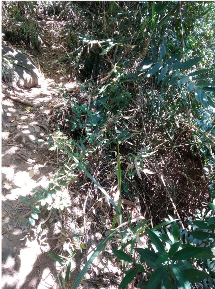
Figura 4.5.3: Imagem do ponto TMI-08 onde a erosão avança por baixo da trilha
