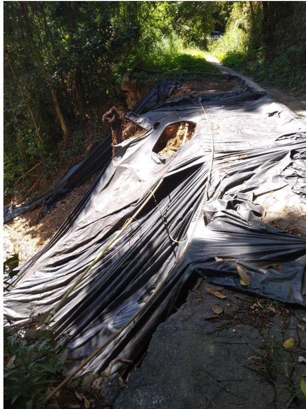
Figura 4.6.2: Imagem do deslizamento no final da trilha, no ponto TRC-20.
