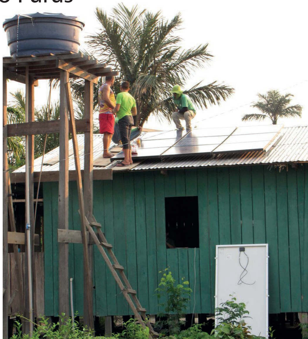
Sistema permite bombear água do rio para as casas dos moradores
